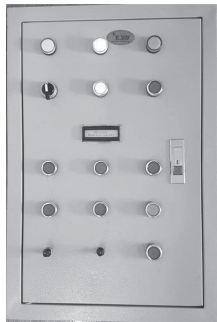
Hình 4.1: Mặt ngoài của tủ điều khiển
