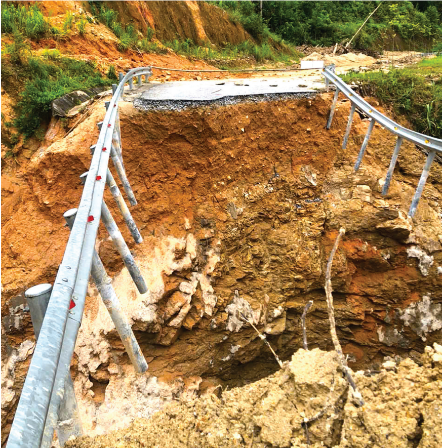
Thiên tai phá hủy kết cấu hạ tầng giao thông
