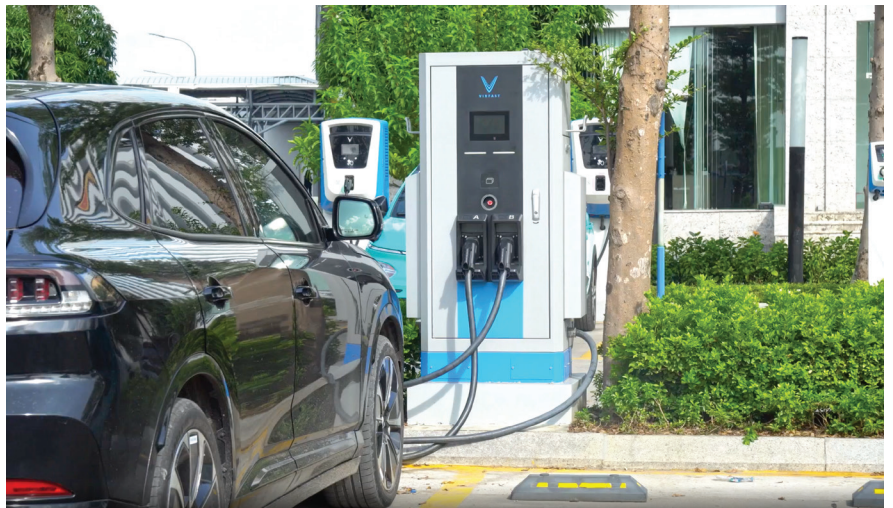
Chưa có quy chuẩn quốc gia nên mỗi nhà đầu tư sẽ sử dụng tiêu chuẩn riêng để xây dựng trạm sạc
