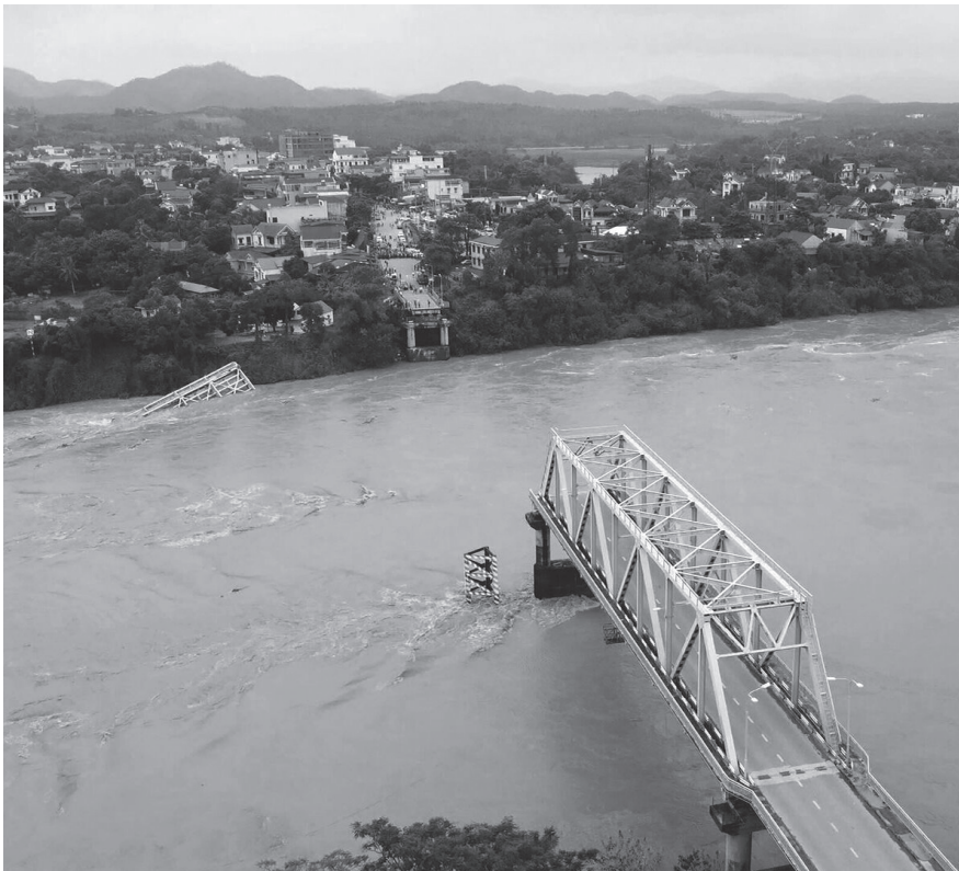
Cầu Phong Châu (tỉnh Phú Thọ) bị sập trong cơn bão số 3
