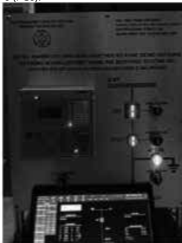
a) - Đóng máy cắt 475 trạm cắt số 5 (PC5) tại chỗ
