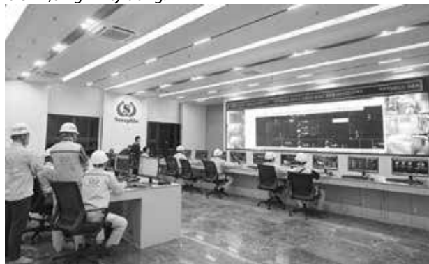
Hình 4. Phòng điều hành trung tâm của Nhà máy điện rác Seraphin được trang bị công nghệ cao, công nghệ số hóa, tự động hóa tiên tiến [9]
