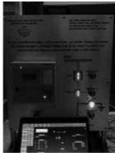
b) - Đóng máy cắt 475 trạm cắt số 5 (PC5) từ xa
